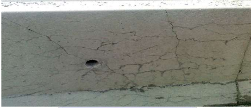
Şekil.1 Karayolu Refüj Korkuluk Betonunda Gözlenen ASR Çatlakları[1]
